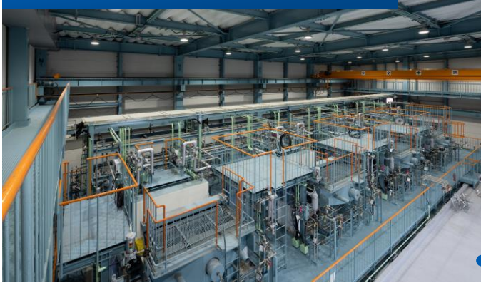
水電解パイロット【神奈川県川崎市】
