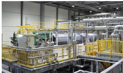
10MW級水電解設備(FH2R)
